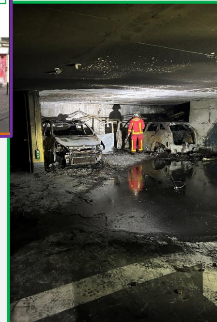
Figure 2 : vue du foyer après extinction
